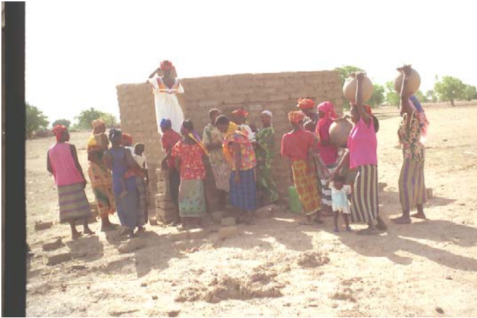
Des femmes de Doué participent à la construction du poste de santé primaire du village.
