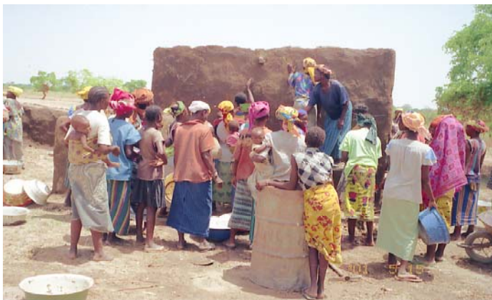
Des femmes du village de Yorgho en train de renforcer les murs de leur poste de santé primaire avec un enduit de banco.
